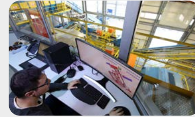
1 OTOMATİK KONTROL ODASI (SCADA)
