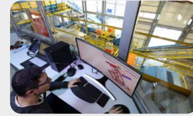
1 OTOMATİK KONTROL ODASI (SCADA)
